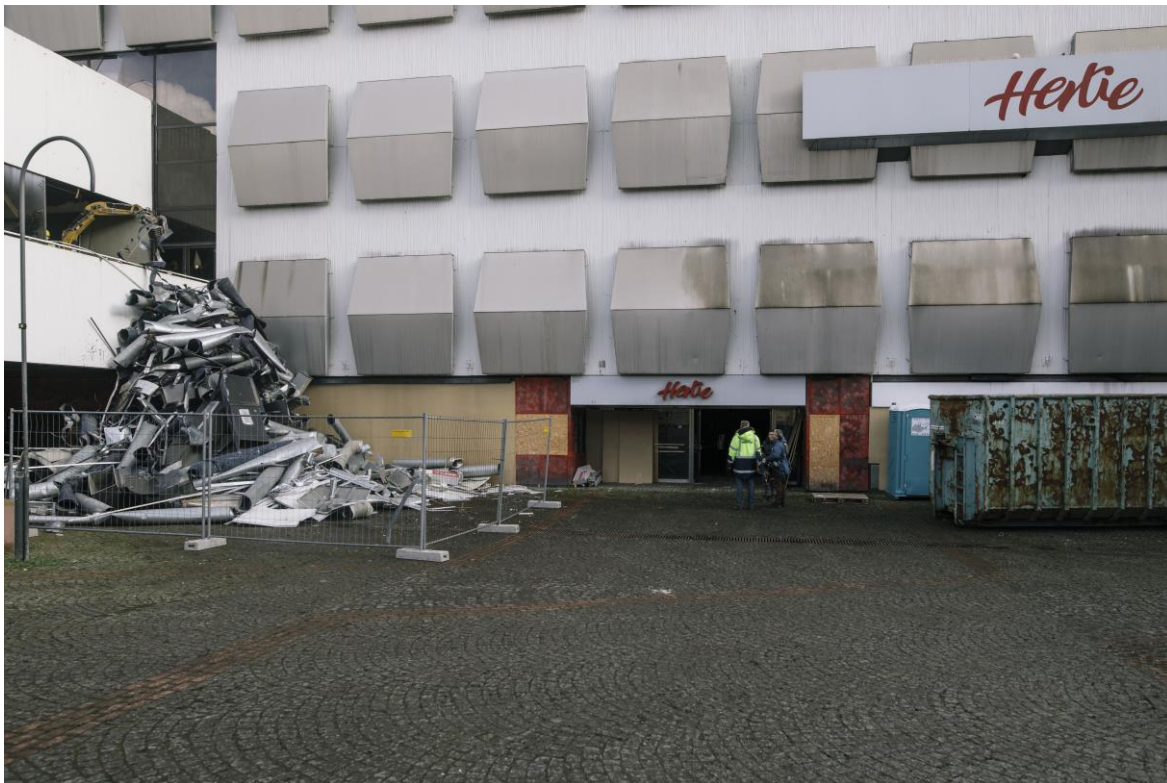
Ehemaliges Hertie-Gebäude von außen: Entrümpelungsmaterial
